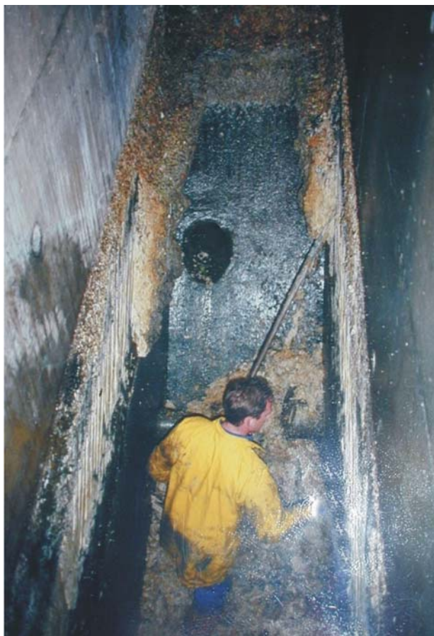
Bild 2: Fettanlagerungen im Pumpwerk Pertisau, entstanden durch nicht gesetzeskonforme Fettentsorgung über die Kanalisation
